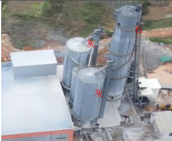
石灰窑和灰块罐
