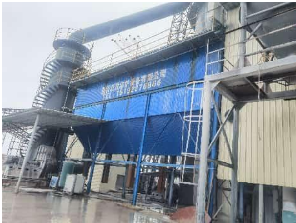
布袋除尘+脱硫塔
