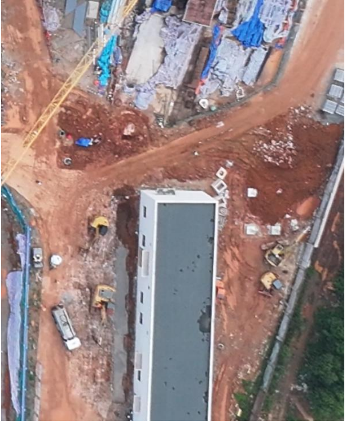
图4-2未建设区域土壤裸露，临时苫盖或草籽绿化措施不完善
