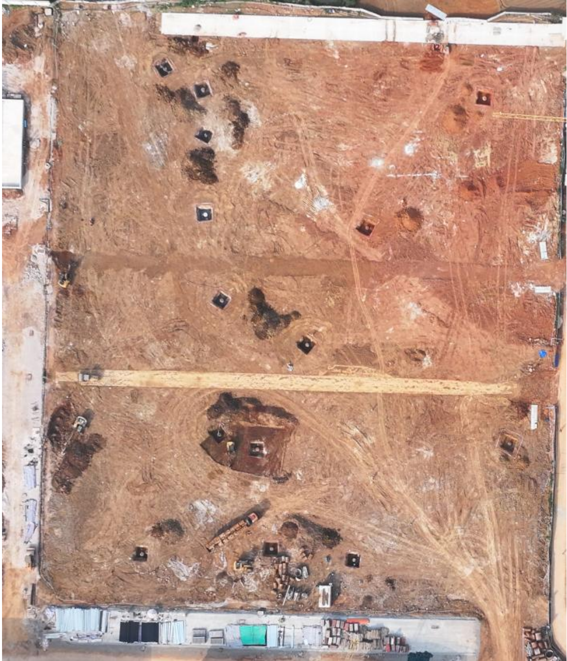
图4-2未建设区域土壤裸露，临时苫盖或草籽绿化措施不完善
