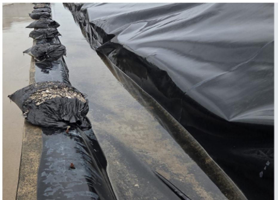
图2.2-2 作业区域的临时排水沟
