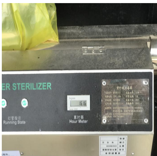
污水处理站-紫外线消毒装置（废水处理）
