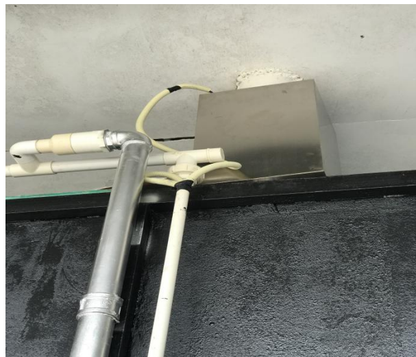
污水处理站-紫外线消毒装置（废气处理）
