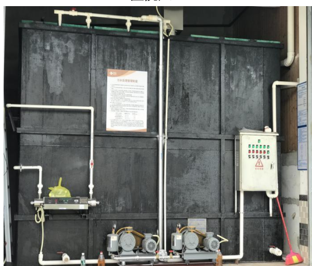
污水处理站-二级处理（好氧厌氧生物法）
