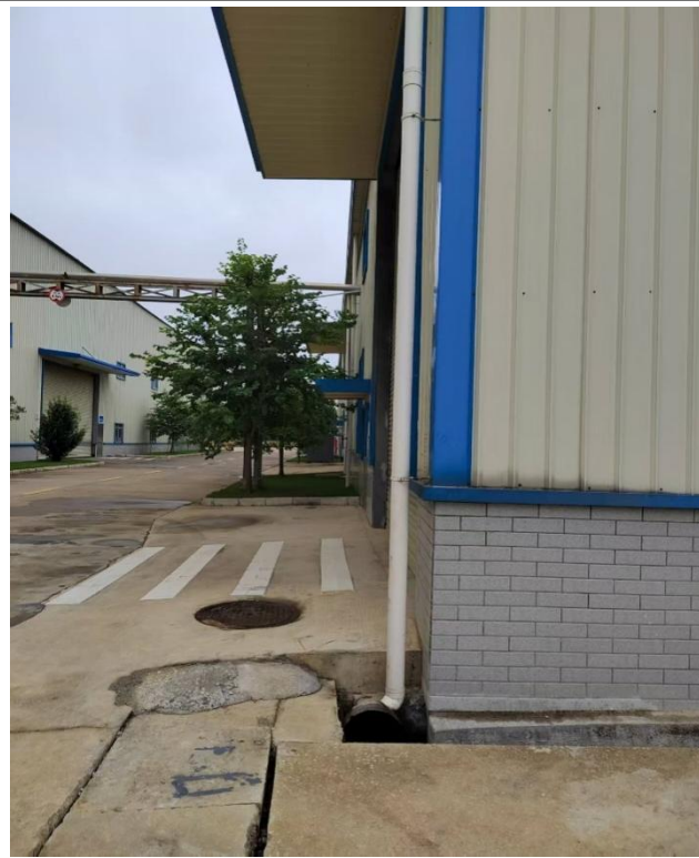
厂区内雨水收集管道
