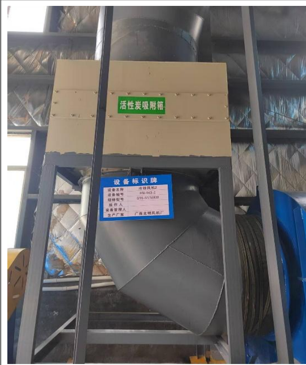
药肥车间废气处理设施-活性炭吸附装置
