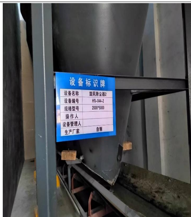
药肥车间废气处理设施-旋风除尘器
