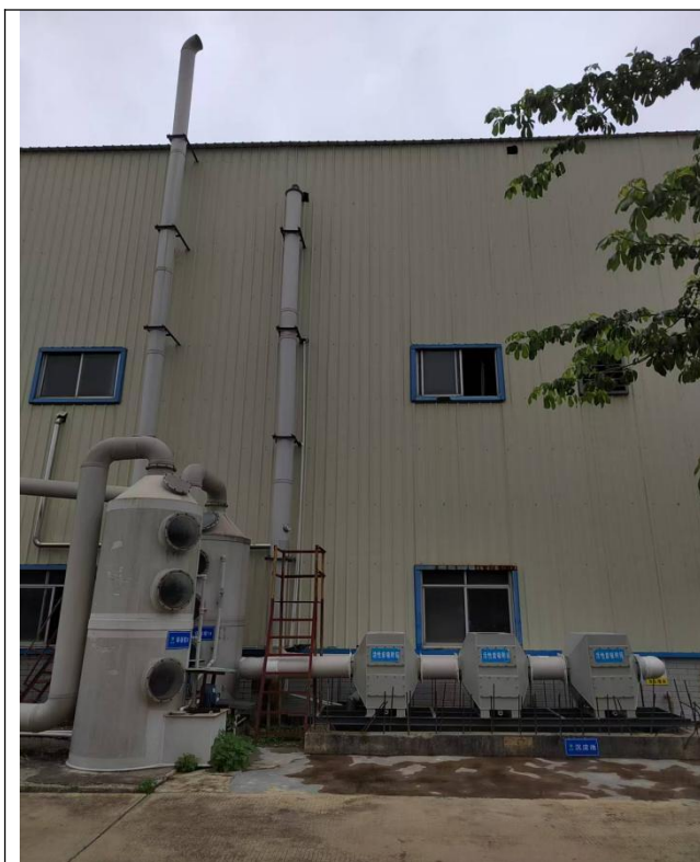
水剂车间废气处理设备(三级活性炭+洗涤塔+除湿除雾)及20m高1#排气筒
