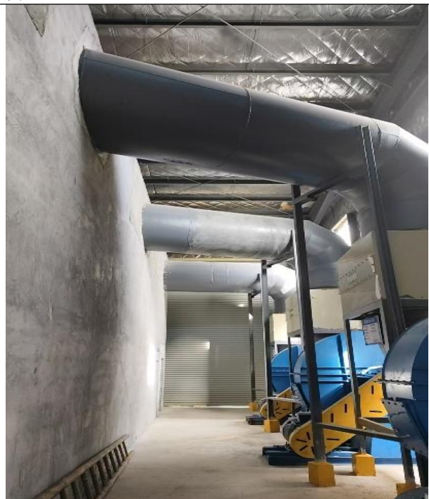
药肥车间废气处理设施-重力除尘室
