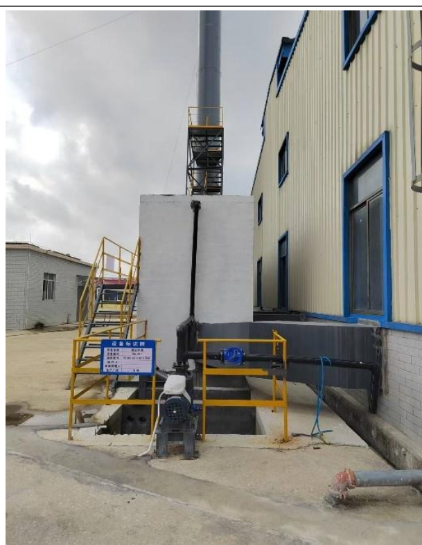
药肥车间废气处理设施(含旋风除尘+重力除尘室+活性炭吸附装置+水喷淋系统)及28m高2#排气筒
