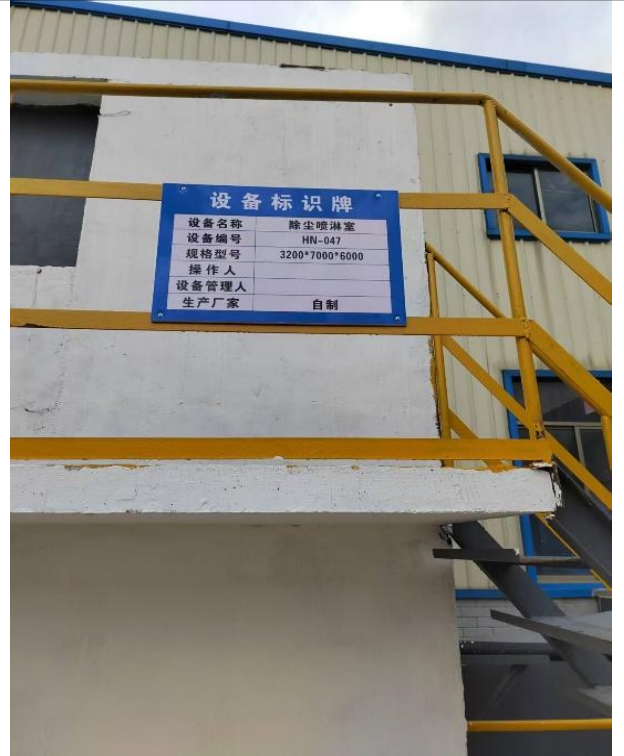
药肥车间废气处理设施-除尘喷淋室
