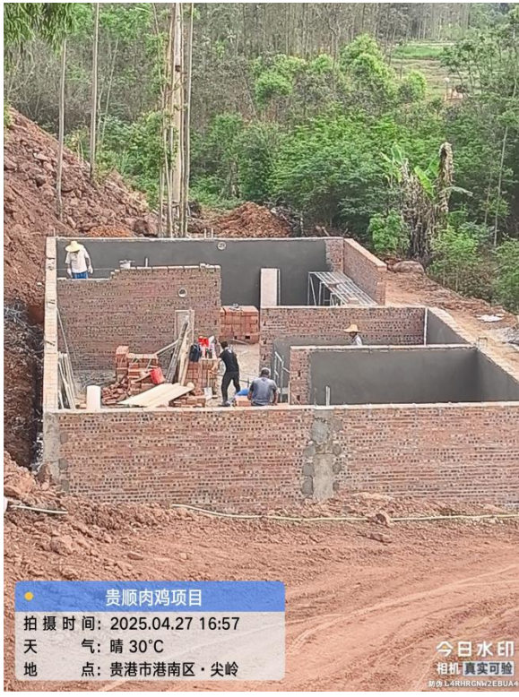
污水收集发酵池（兼初期雨水池）、暂存池（兼事故应急池）建设过程照片（现已建设完成埋于地下）
