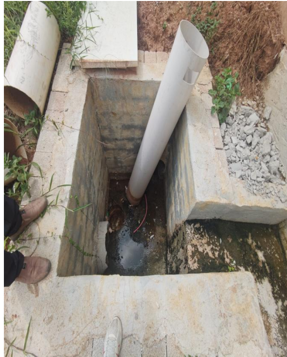
污水收集发酵池（兼初期雨水池）入口转换阀
