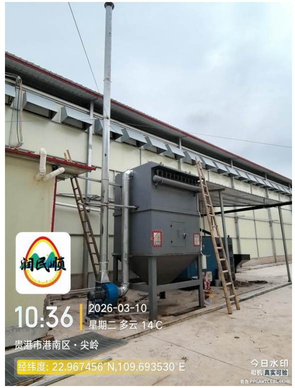
锅炉布袋除尘
