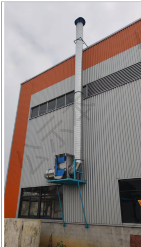
活性炭装置+DA002 排气筒
