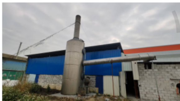
喷淋塔+DA001 排气筒
