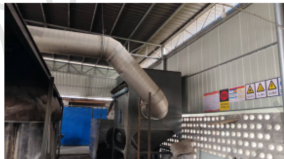
熔化工序和浇注工序产生的颗粒物与熔化炉生物质成型颗粒燃料燃烧废气布袋除尘
