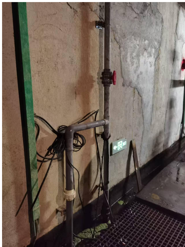
事故池抽回污水处理站处理的管道
