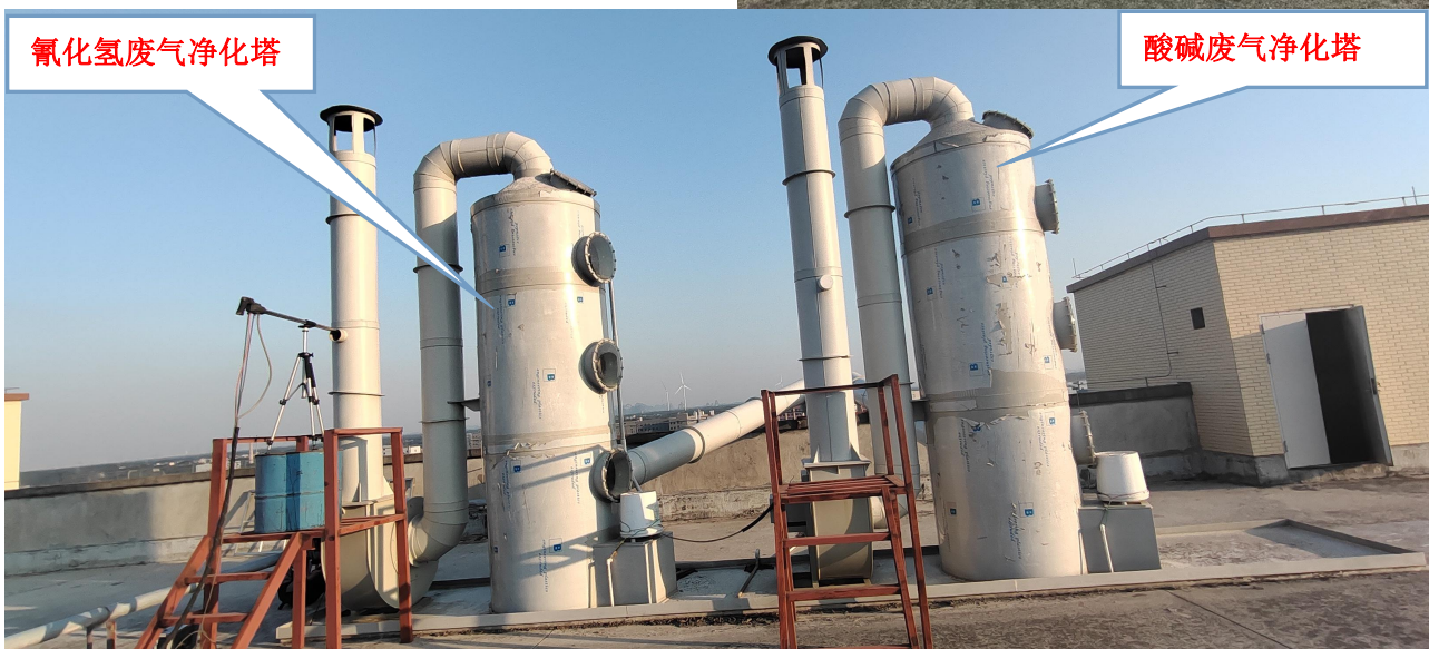
5号厂房第3层挂镀镍、镀白铜锡生产线酸碱废气净化塔及其37m高15#排气筒（内径0.6m）、氰化氢废气净化塔及其37m高16#排气筒（内径0.6m）（均位于楼顶）
