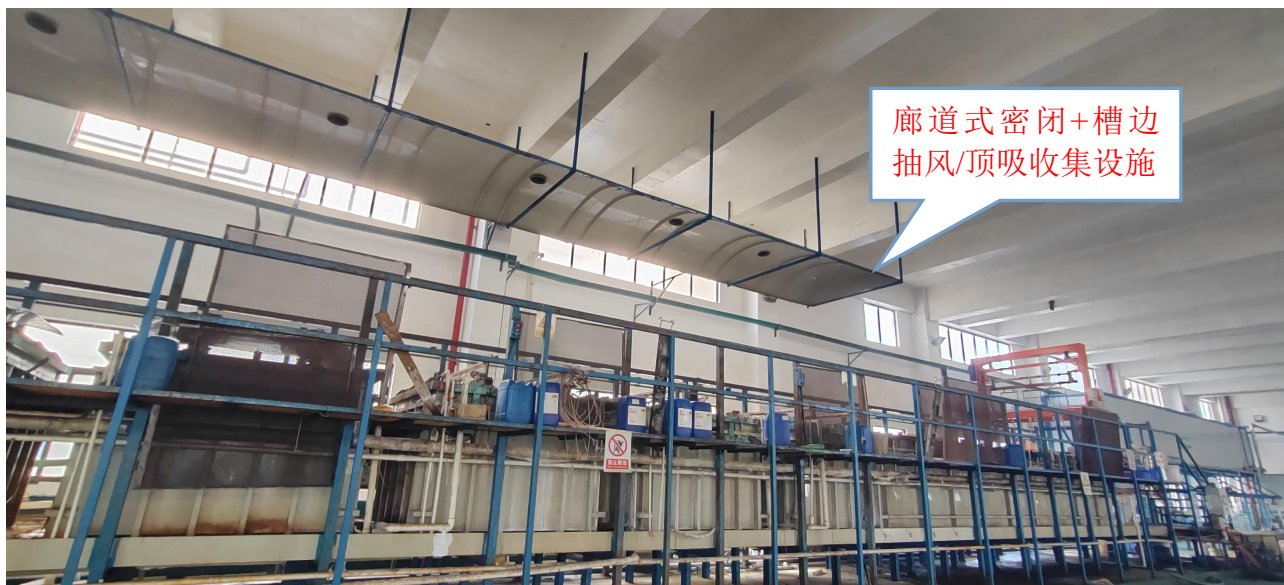
4号厂房第2层挂镀锌生产线
