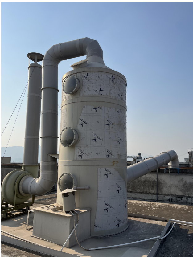
4号厂房第2层挂镀锌生产线酸碱废气净化塔及其37m高18#排气筒（内径0.6m）（位于楼顶）
