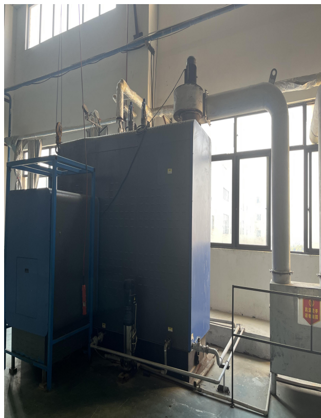
4号厂房的1台3t/h生物质锅炉（备用供热）
