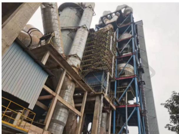
依托的窑尾废气处理设施（低氮燃烧技术+SNCR脱硝技术脱硝+布袋除尘器处理技术）
