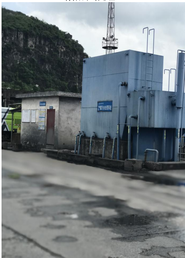
2#煤污水处理站(依托广西贵港北港国际集装箱码头有限公司处理)
