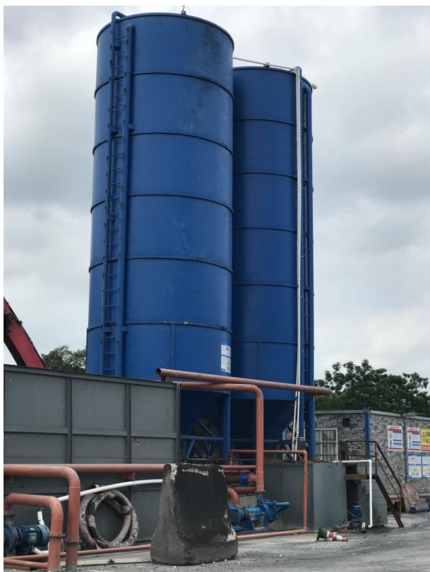
三级沉淀水罐(依托广西贵港北港国际集装箱码头有限公司处理)
