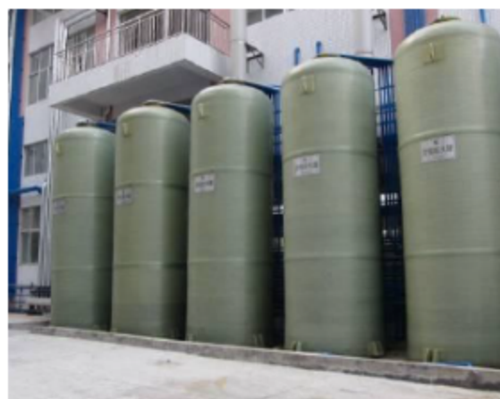
江门市新会崖门定点电镀工业基地车间外废水分类收集罐
