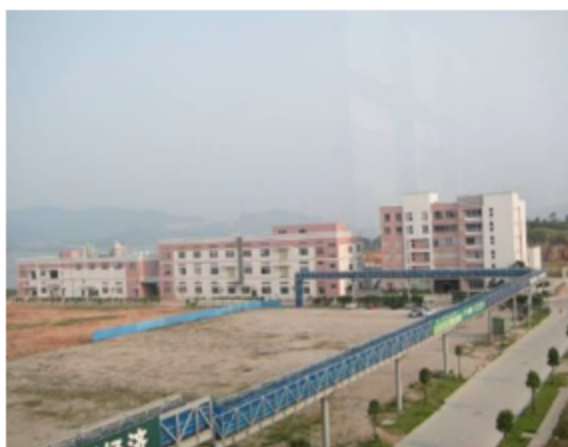
江门市新会崖门定点电镀工业基地废水分类管道管架
