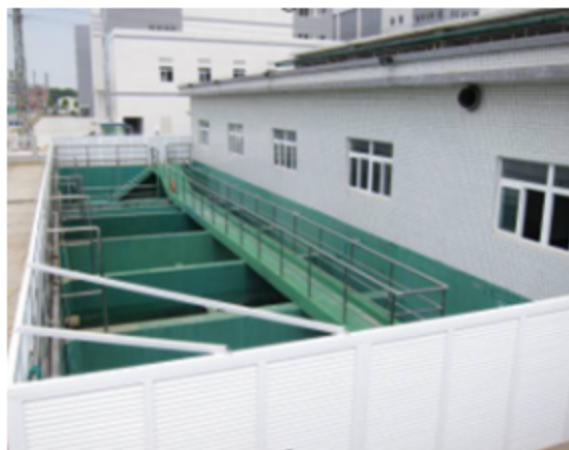
博罗县龙溪电镀基地废水预处理分类收集池
