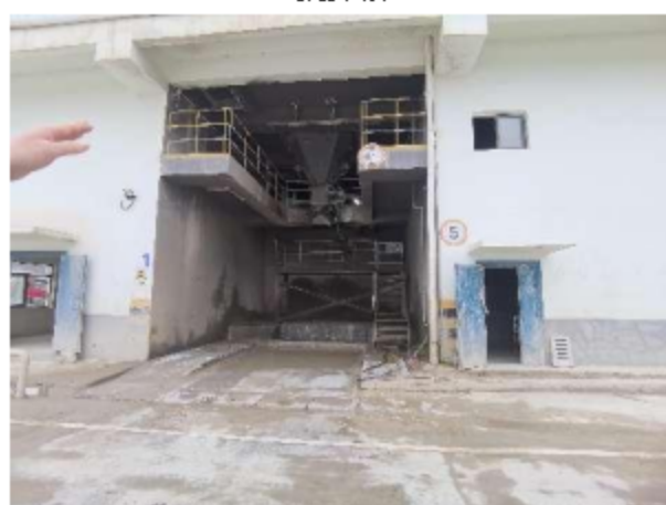
搅拌楼装车位置
