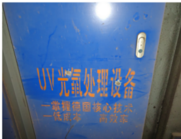
喷塑、烘干车间废气处理设施 2
