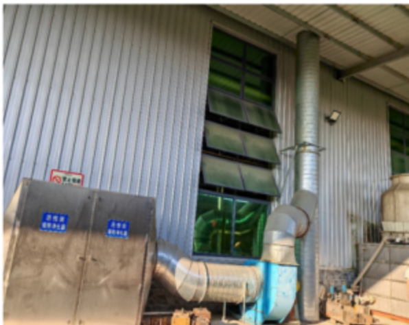
注塑、制线废气排气筒（3#）
