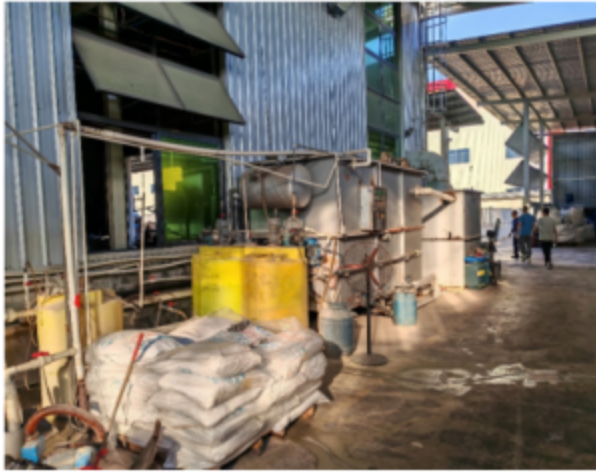
污水处理设施
