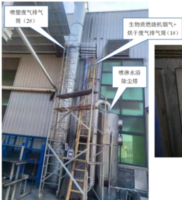
喷塑、烘干车间排气筒+生物质燃烧机除尘塔+排气筒
