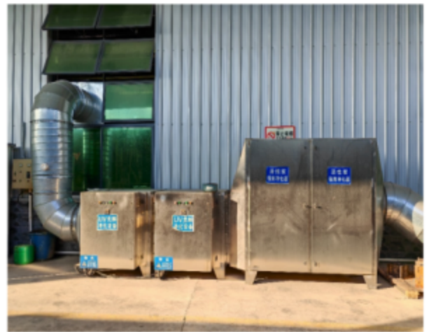
注塑、制线废气处理设施（活性炭+UV 光氧）
