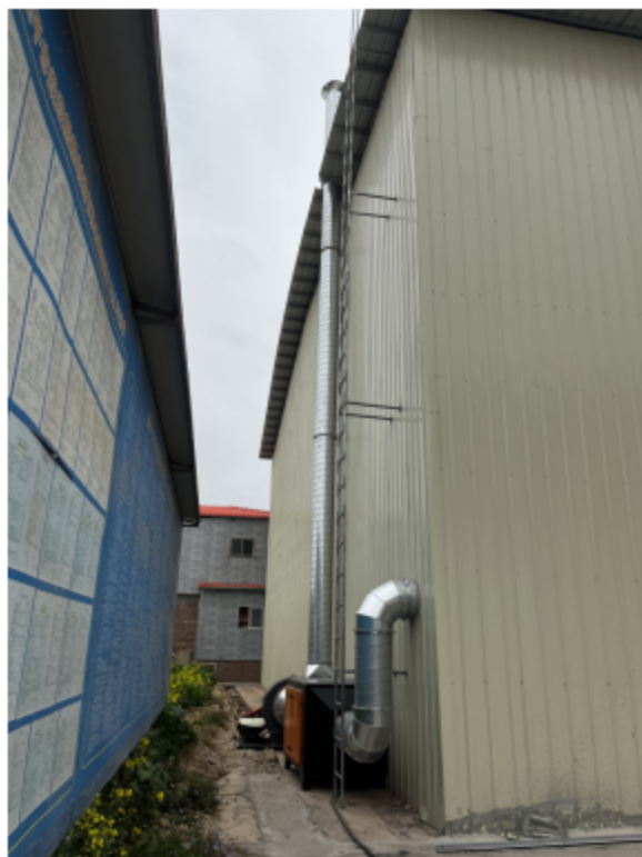
涂装废气处理设施
