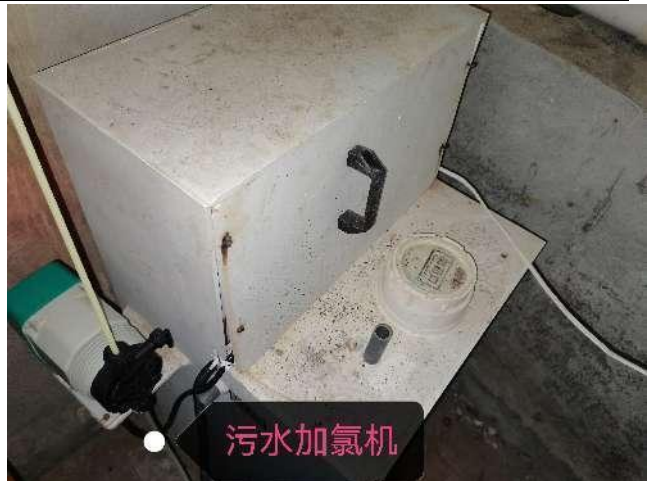
污水处理站-加氯机
