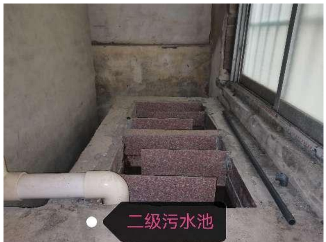
污水处理站-二级污水池
