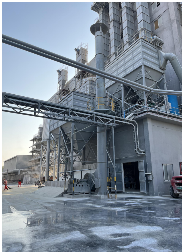
筛分、破碎除尘器
