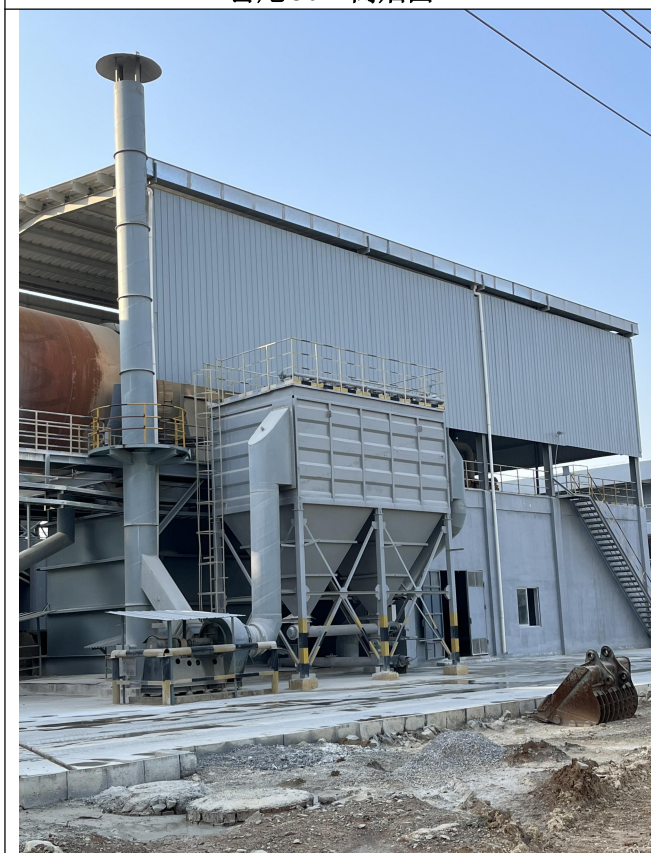
窑头布袋除尘器+排气筒
