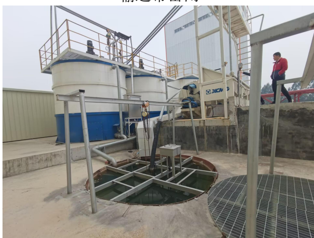
生产废水回用系统（沉淀+砂石分离+板框压滤机）
