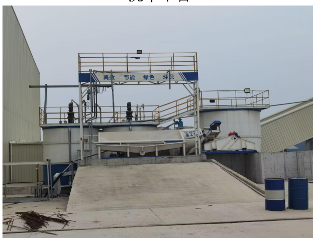
生产废水回用系统（沉淀+砂石分离+板框压滤机）
