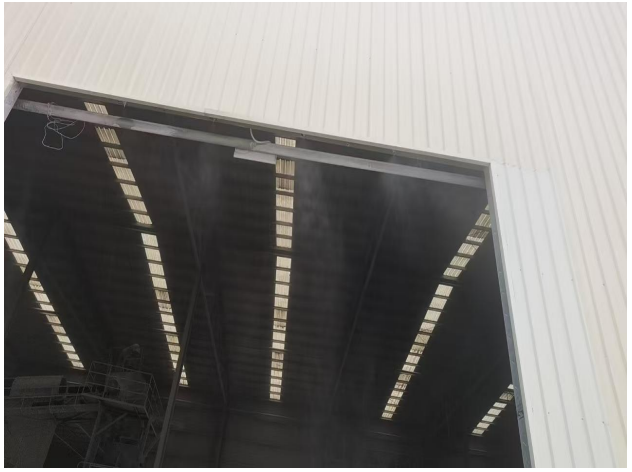
厂房喷淋措施
