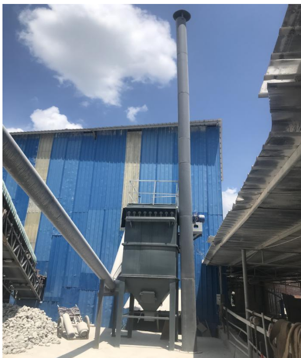
布袋除尘器及排气筒
