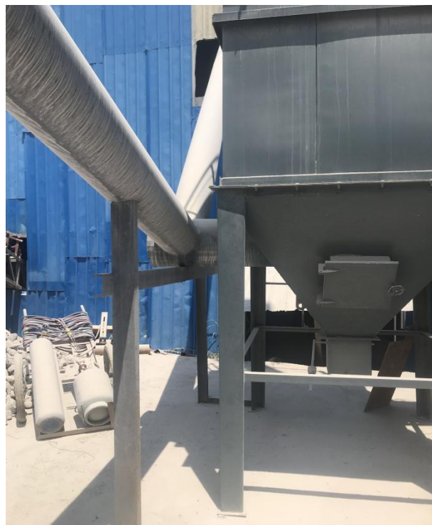
布袋除尘器进口抽风管道
