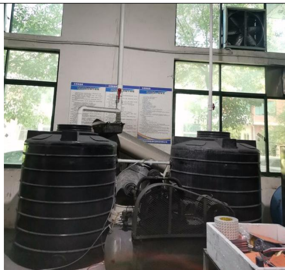
废水收集装置（混凝沉淀处理）
