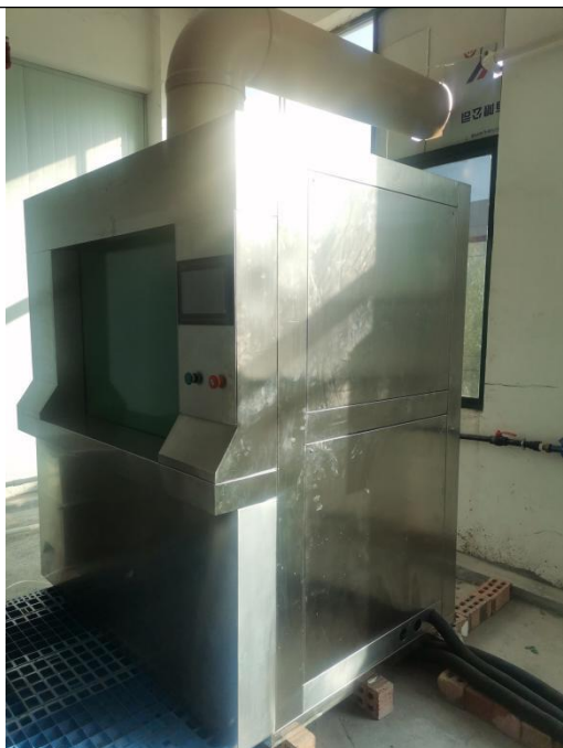
电抛废气管道收集设施
