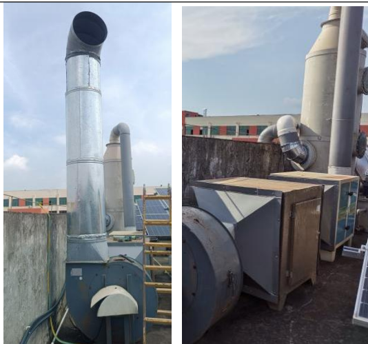
喷漆废气处理设施
