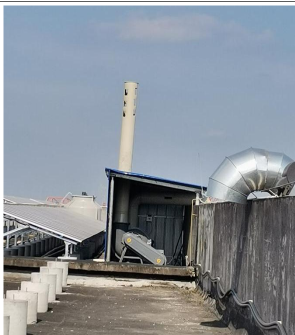
电抛废气排放口
