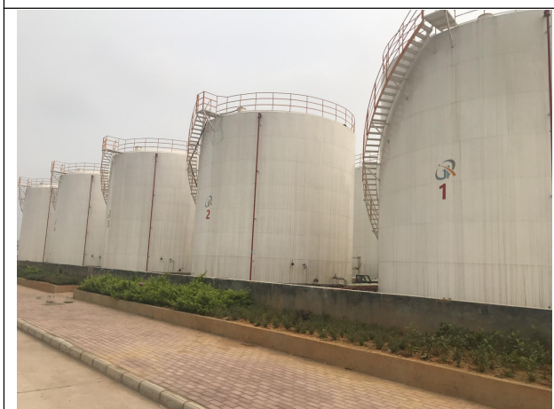
原料罐、干燥油罐、粗酯分层罐、粗酯罐及围堰
