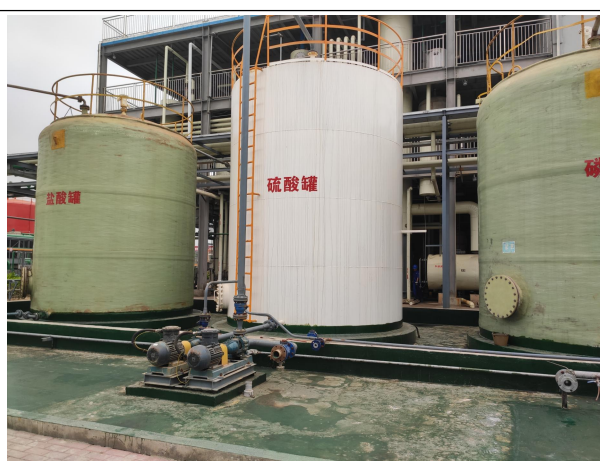
盐酸罐、硫酸罐、磷酸罐及围堰
