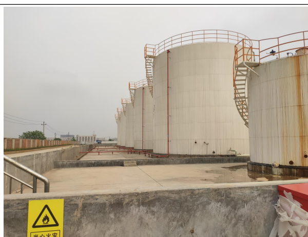
甘油罐、植物沥青罐、轻组分罐、生物柴油罐及围堰
