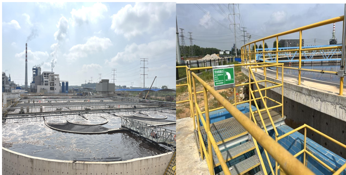
漂白浆项目污水处理站及排放口
