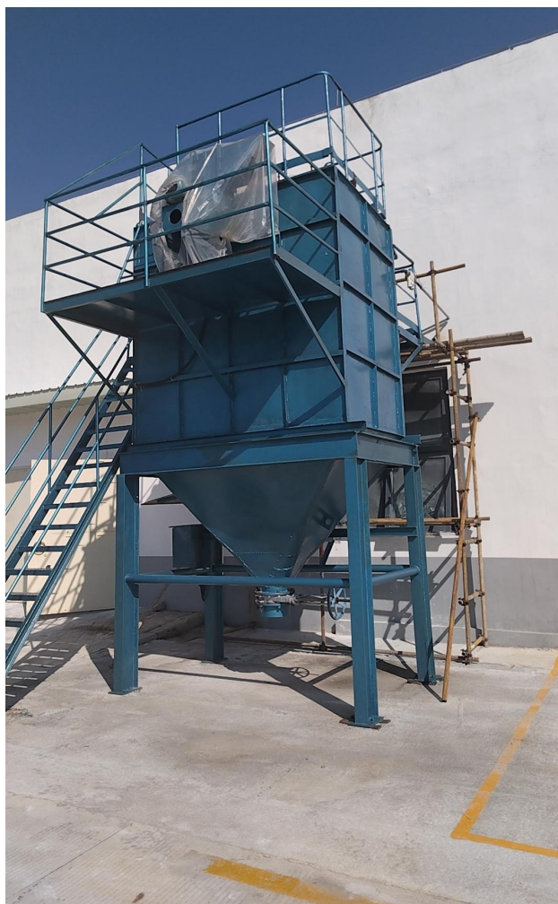
布袋除尘设施
