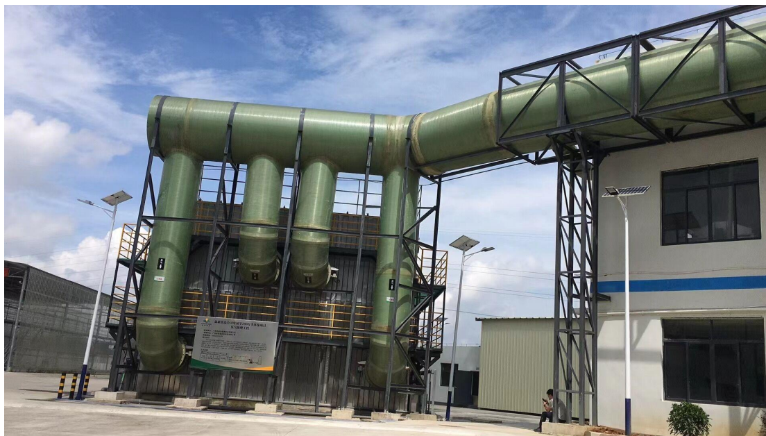
生物除臭系统（进气口）
