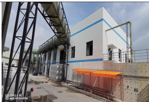
废气收集管道
