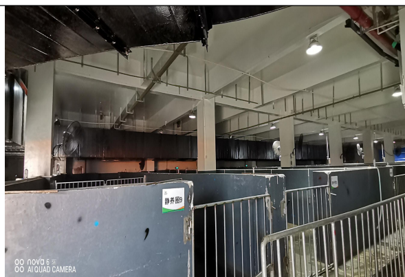
待宰圈废气收集管道
