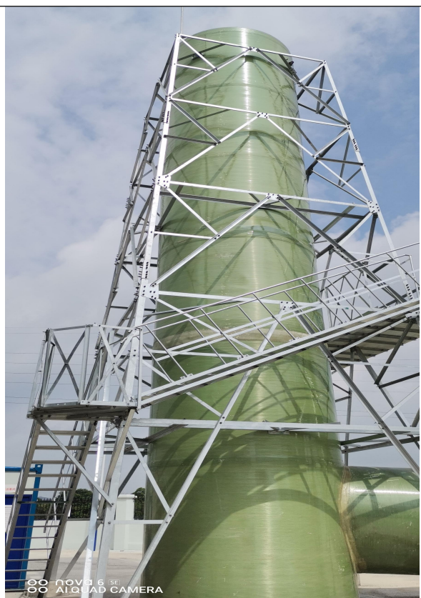
15m 高排气筒
