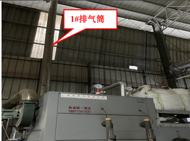
蒸汽发生器排气筒
