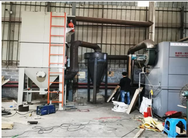
1.5t/h 生物质蒸汽发生器废气旋风+布袋除尘措施
