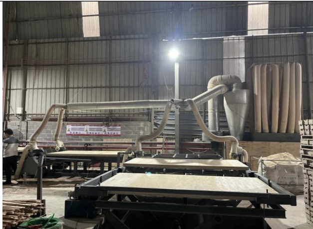
锯边区及其配套的吸尘软管+布袋除尘器
