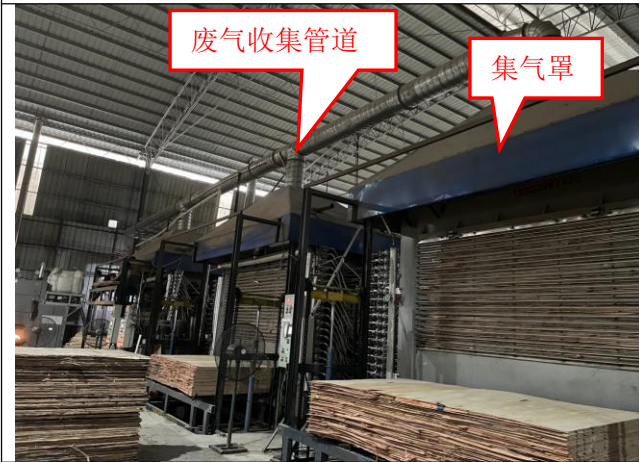
热压区及废气收集措施
