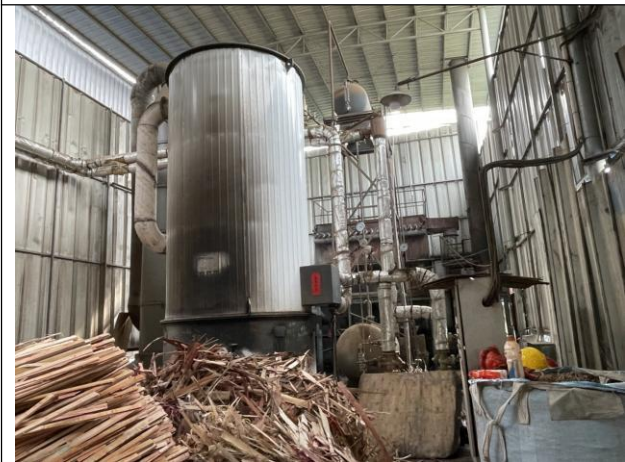
原有导热油锅炉（停用）
