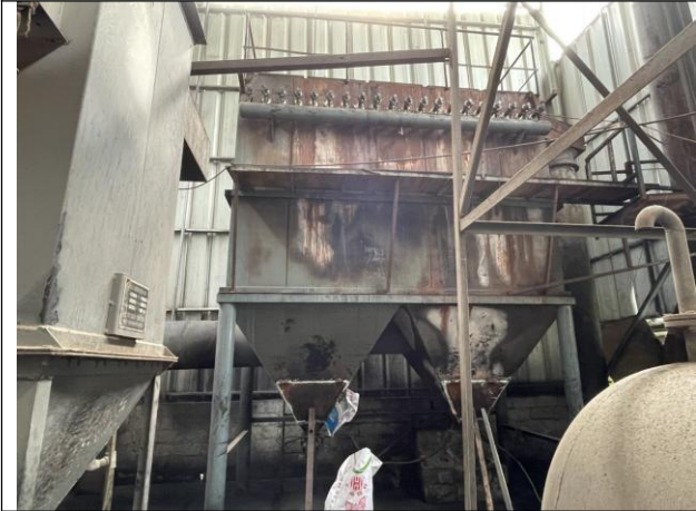
锅炉旋风+陶瓷多管+喷淋塔+布袋除尘系统
