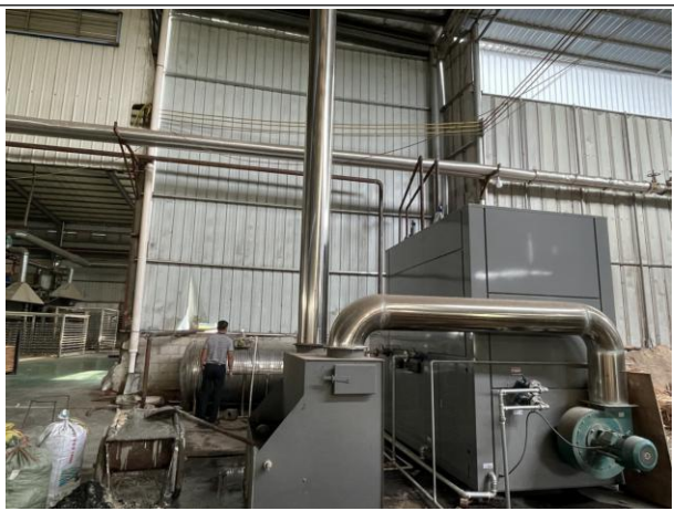
现有生物质蒸汽发生器（2.5t/h）
