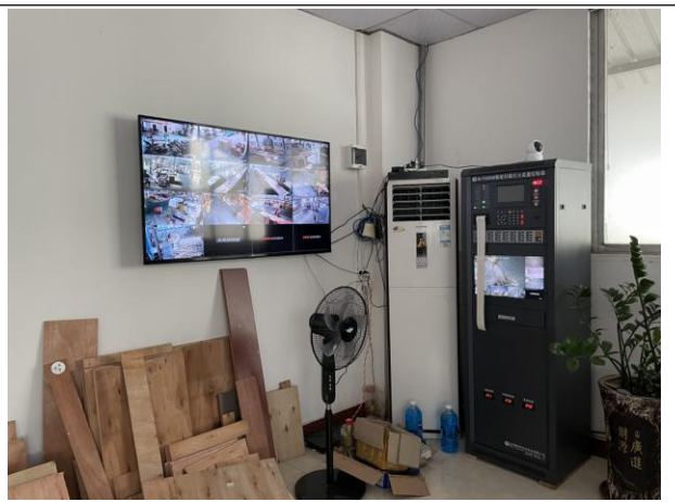
厂区视频监控和火灾自动灭火装置
