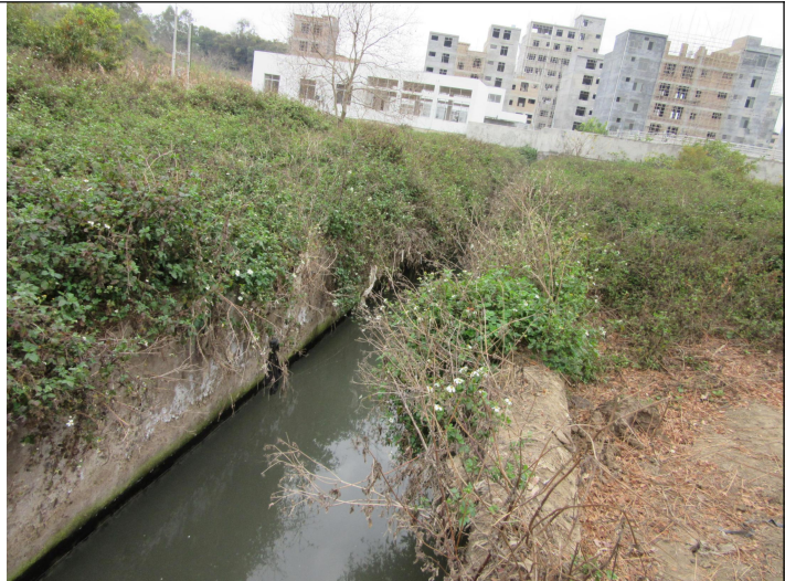
木乐镇污水处理厂排水渠
