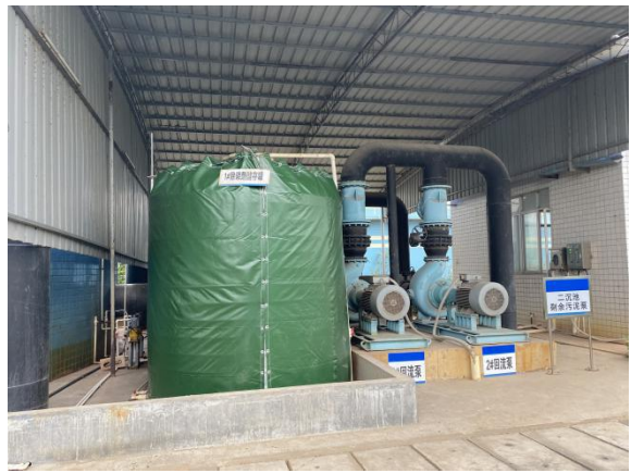
除磷药剂储罐
