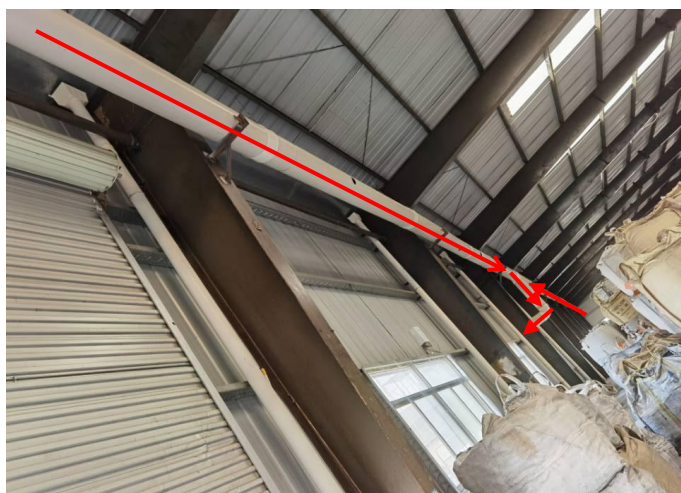
仓库内废气收集管 1
