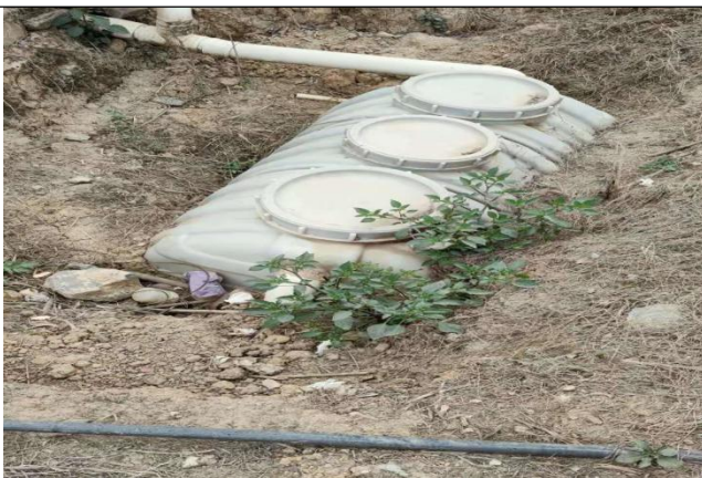
生活污水三级化粪池
