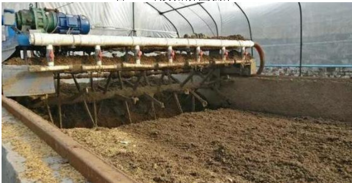
图 2.2-4 同类项目异位发酵床内翻耙机
