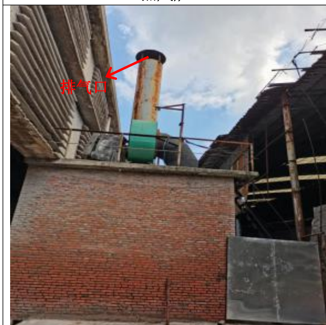
重力沉降室+15m 高排气筒 (D1)
