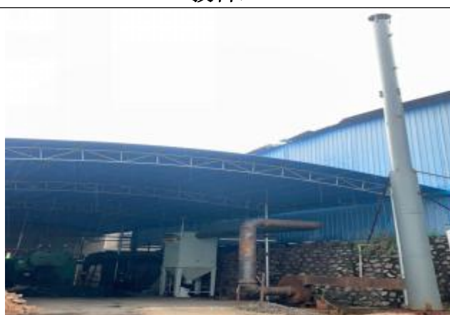
锅炉布袋除尘+18m 高烟囱 (D3)
