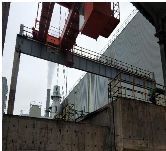
浊环平流沉淀池及清渣设备
