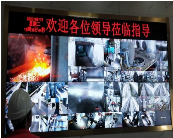
中控室显示屏
