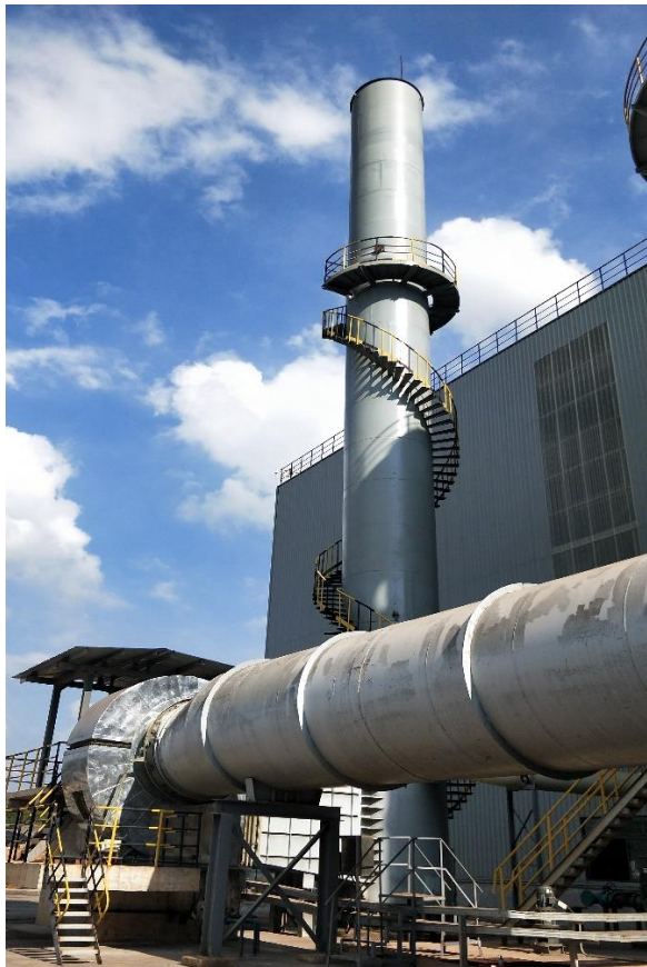
排气筒及监测平台
