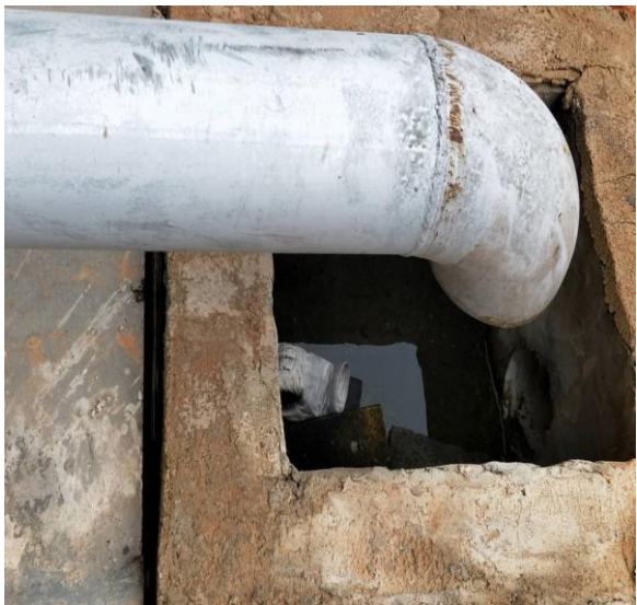
屋面雨水收集井
