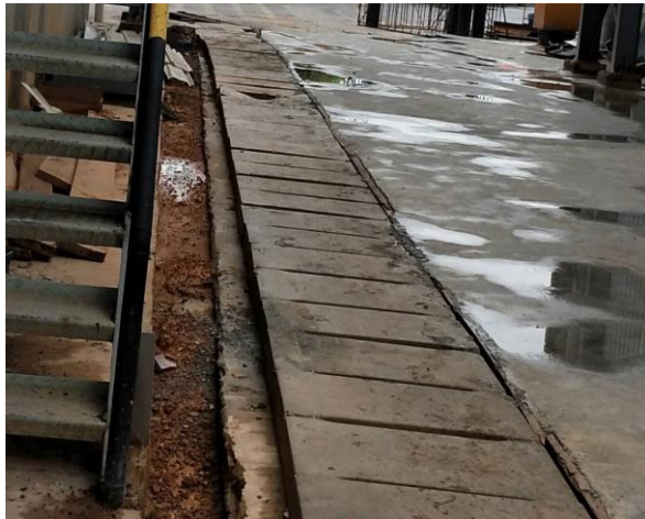
厂区雨水收集沟
