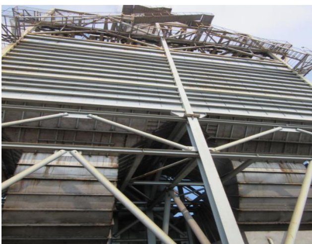
湿电除尘系统
