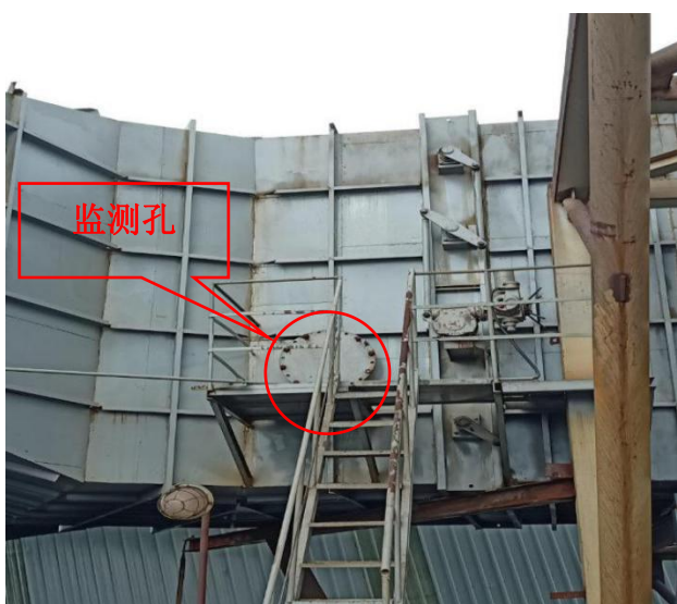
烧结机头烟气进入脱硝系统前监测孔及监测平台
