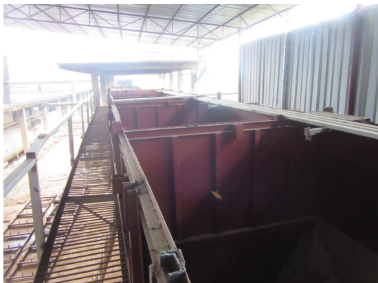
污水处理池（漏斗形，四格）
