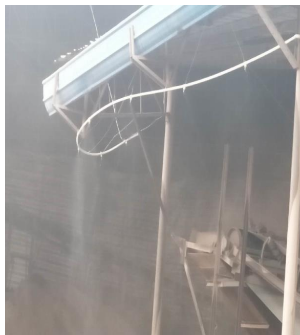
喷淋降尘装置
