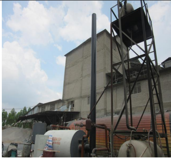
导热油炉及排气筒
