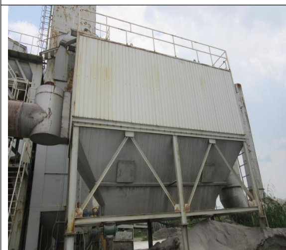
布袋除尘器及排气筒
