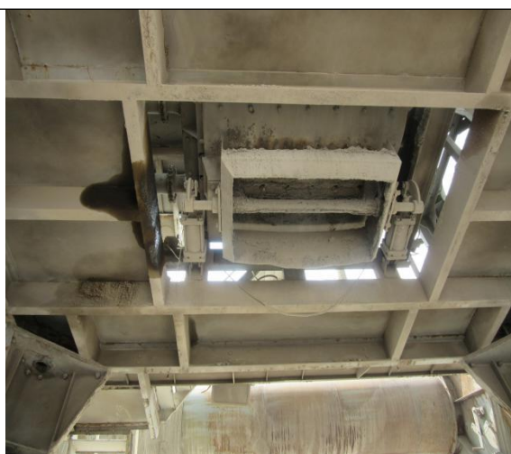
下料口（加盖板、抽风管）
