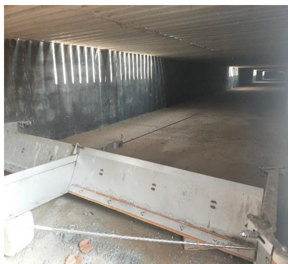
集污槽+自动刮粪板
