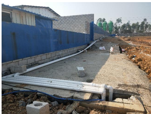
密闭的集污池+粪污输送管道
