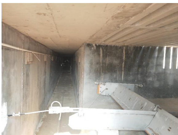
集污槽+自动刮粪板
