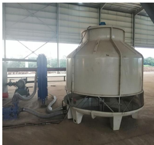
废水循环冷却设施
