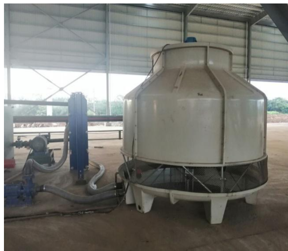
净循环水冷却塔
