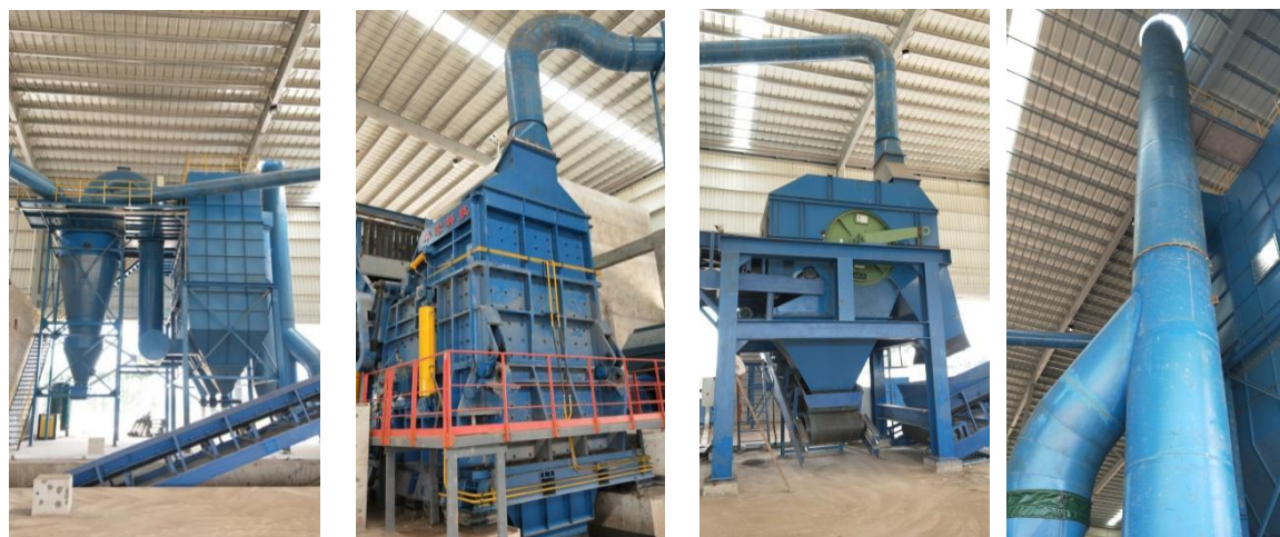
旋风分离器+布袋除尘器 破碎机集气罩 磁选机集气罩 排气管道
