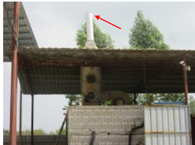
硫酸雾吸收塔及 10m 高排气筒
