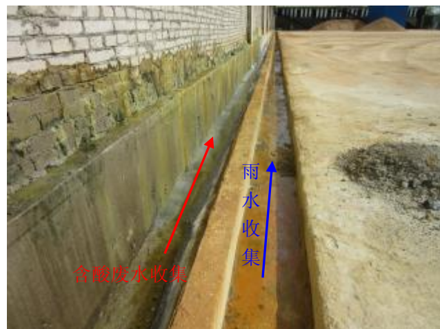
产品堆棚外含酸废水、雨水收集管网
