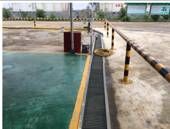
项目区雨水管网
