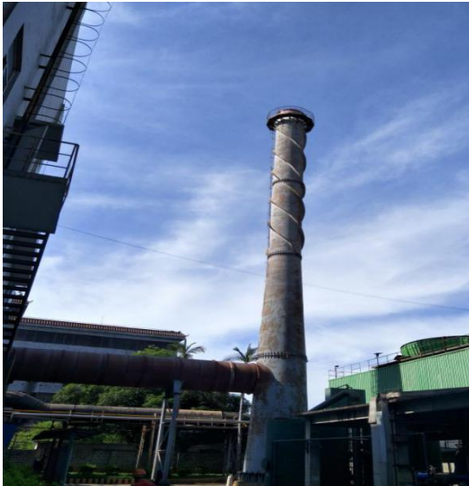
燃气锅炉烟囱
