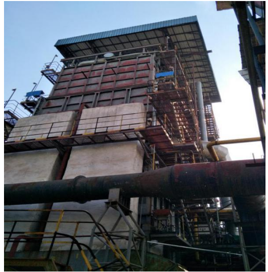
燃气锅炉主楼
