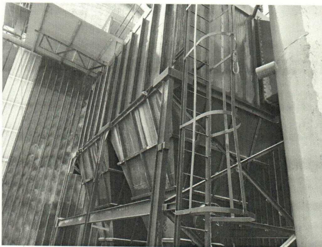
生料库顶布袋除尘器
