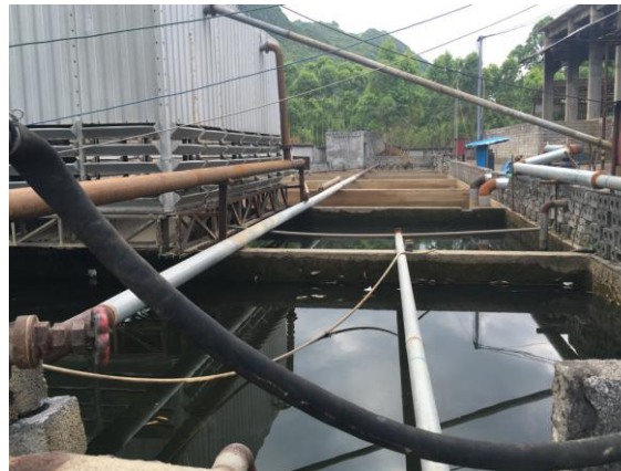
冷却水循环回用池
