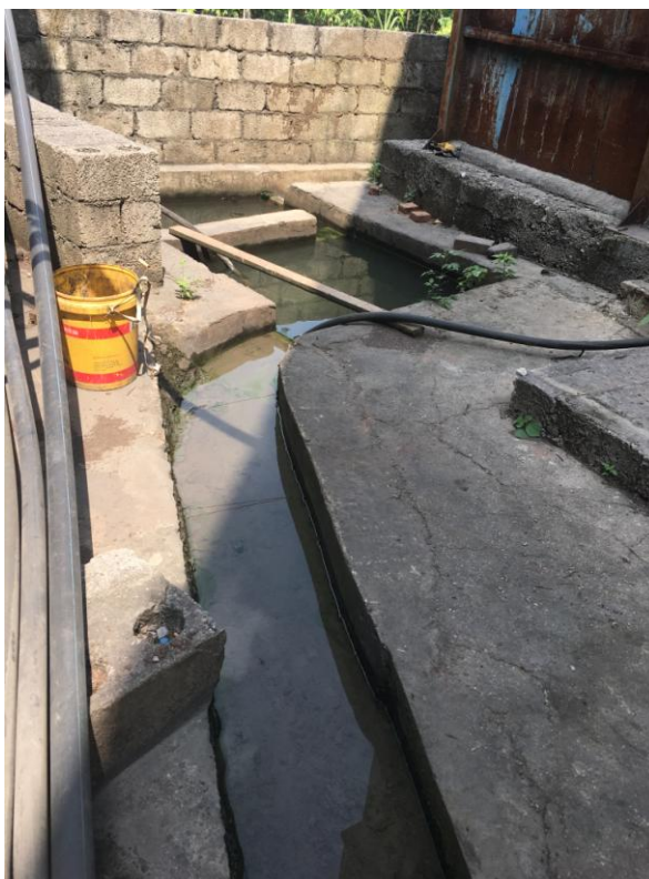
初期雨水沉淀池
