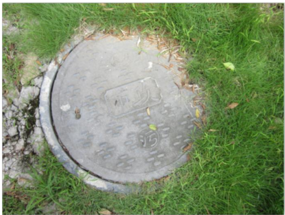
项目生活污水排入市政管网接入口
