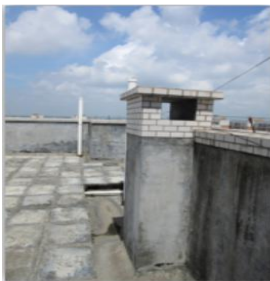
位于楼顶的油烟废气排放口
