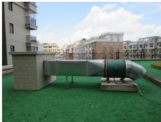
地下场废气排放口
