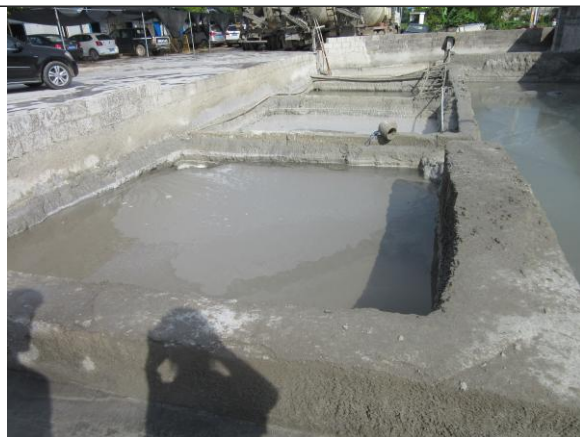
车辆清洗废水沉淀池
