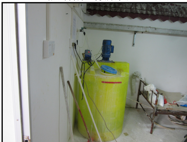
污水处理站加药罐
