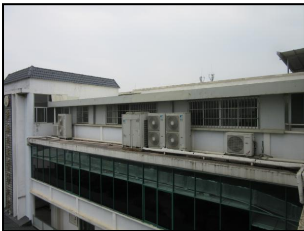
室外空调机组
