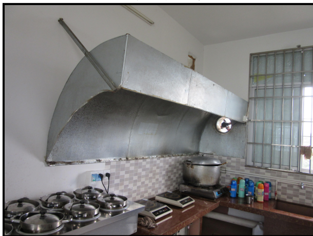
煎药房集气收集设施
