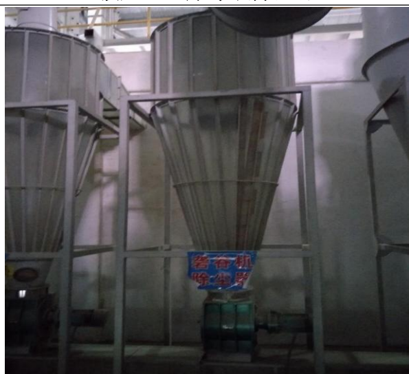
砻谷工序布袋除尘器
