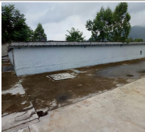
初期雨水收集池
