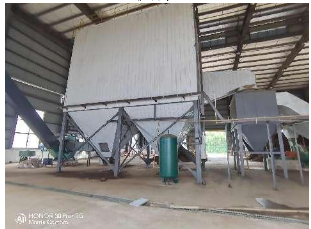
锅炉房布袋除尘设备
