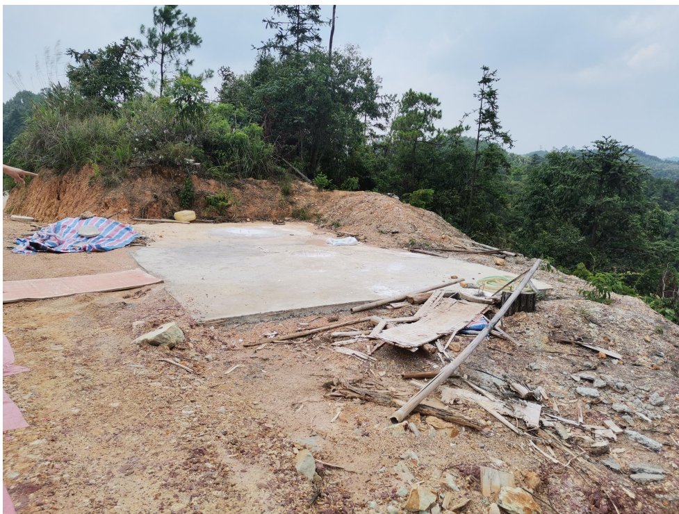
无害化处理设施-安全填埋井
